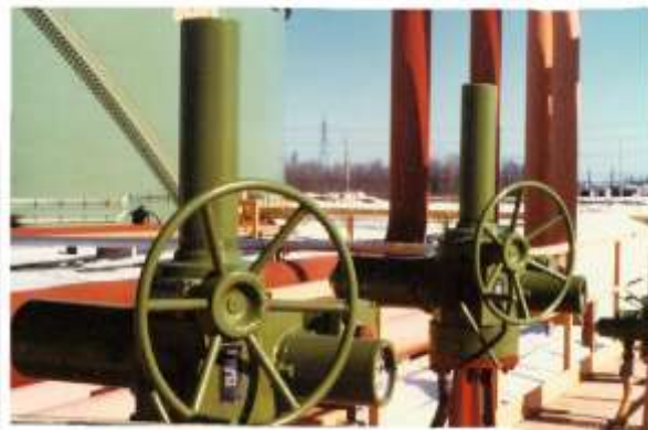
Réservoir de brut
